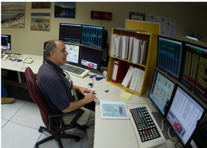
242-A control room
